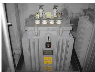
高圧変圧器（トランス）
